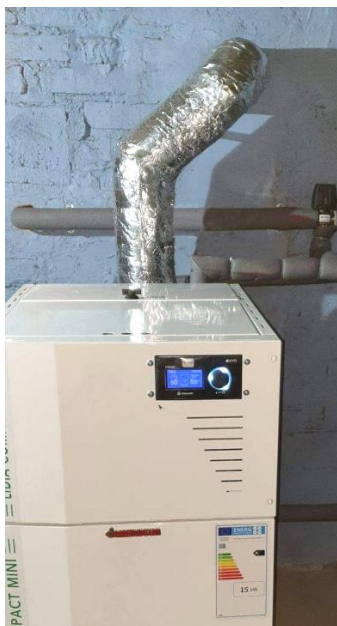
Przykład zaizolowanej rury
